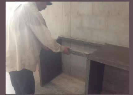
6 วางตัวคาน (lintel) เพื่อประกอบเป็นหลุมซิงค์
